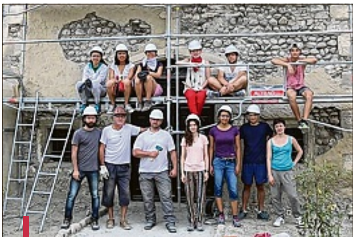
Des volontaires de l'association Concordia réalisent les travaux à la chapelle Saint-Michel.
