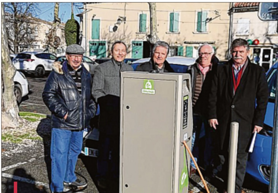
Les bornes de recharge pour les véhicules électriques sont installées sur le parking devant la mairie.
